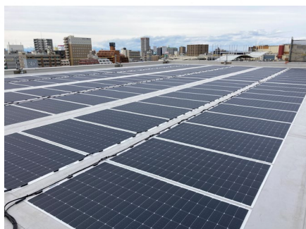
市役所屋上のパネル
