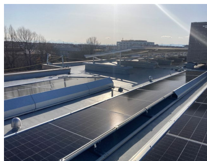
武里南小学校屋上のパネル
