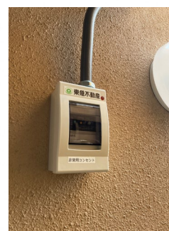
非常用コンセント
