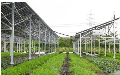
リエネソーラーファーム東松山太陽光発電所
